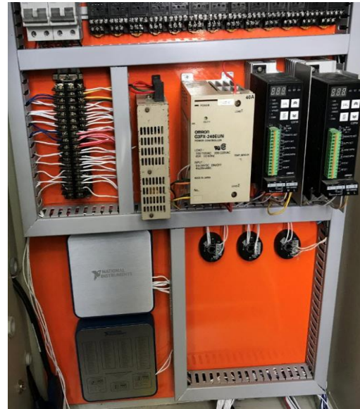
Hình 7.34 Hệ thống điều khiển trung tâm
